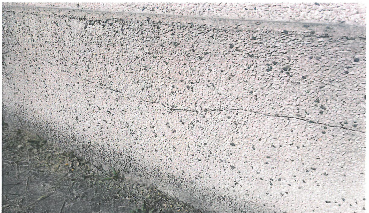
Fot. Nr 16. Budynek mieszkalny/przedszkole. Data powstania 1906-1910 r. Ul. Ks. Mazurkiewicza 34 Jasień. Gmina Brzesko. Zbliżenie fragmentu tynku od strony pld./zach. Stan: przed konserwacją. Widoczne: wyprawa tynkarska z lat 90 tych XX w. - rozległe, wzdłużne pęknięcie ujawniające odspojenie w-wy tynkarskiej. Fot. Wojciech Siek . 05. 2022
