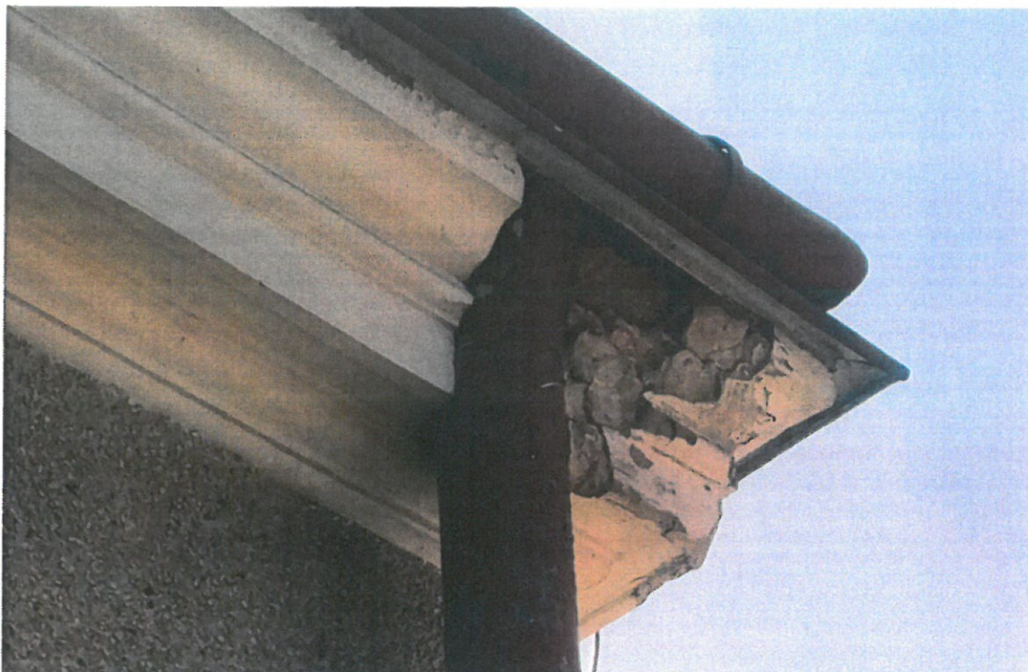
Fot. Nr 7. Budynek mieszkalny/przedszkole. Data powstania 1906-1910 r. Ul. Ks. Mazurkiewicza 34 Jasień. Gmina Brzesko. Zbliżenie rynny spustowej od strony płn./wsch. Stan: przed konserwacją. Widoczne: uszkodzony fragment profilowania gzymsu narożnego, osypujące się warstwy tynku i poluzowane cegły rdzenia. Fot. Wojciech Siek . 05. 2022
