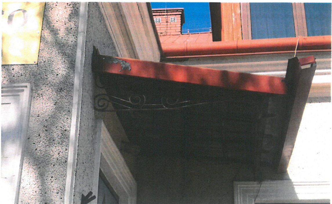
Fot. Nr 6. Budynek mieszkalny / przedszkole. Data powstania 1906-1910 r. Ul. Ks. Mazurkiewicza 34 Jasień. Gmina Brzesko. Widok zadaszenia przy ganku od strony pnw/wsch. Stan: przed konserwacją. Widoczne: dobudowane z kątowników i prętów w późniejszym okresie zadaszenie schodów, gruboziarnisty tynk również z późniejszego okresu. Fot. Wojciech Siek . 05. 2022
