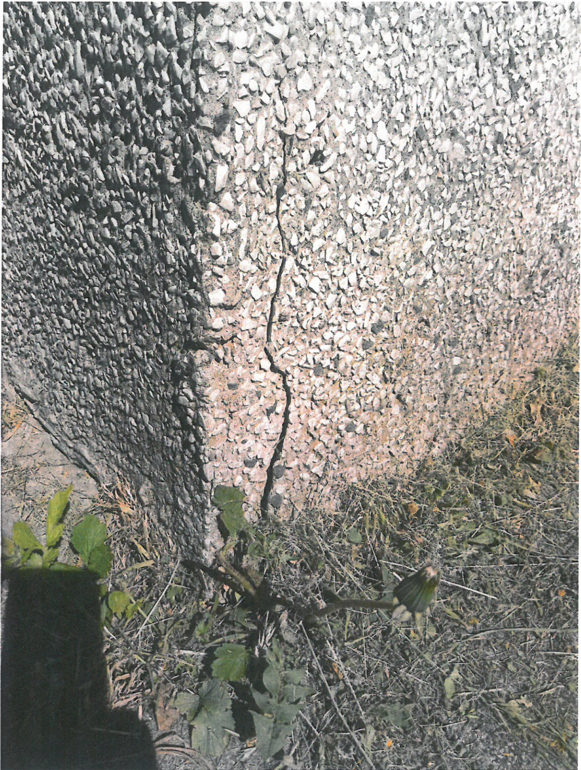
Fot. Nr 17. Budynek mieszkalny/przedszkole. Data powstania 1906-1910 r. Ul. Ks. Mazurkiewicza 34 Jasień. Gmina Brzesko. Zbliżenie narożnika tynkowanego cokołu budynku od strony zł. brzozy Stan: przed konserwacją. Widoczne: gruboziarnista wyprawa tynkarska z lat 90 tych XX w. rozległe pęknięcie. Fot. Wojciech Siek . 05. 2022
