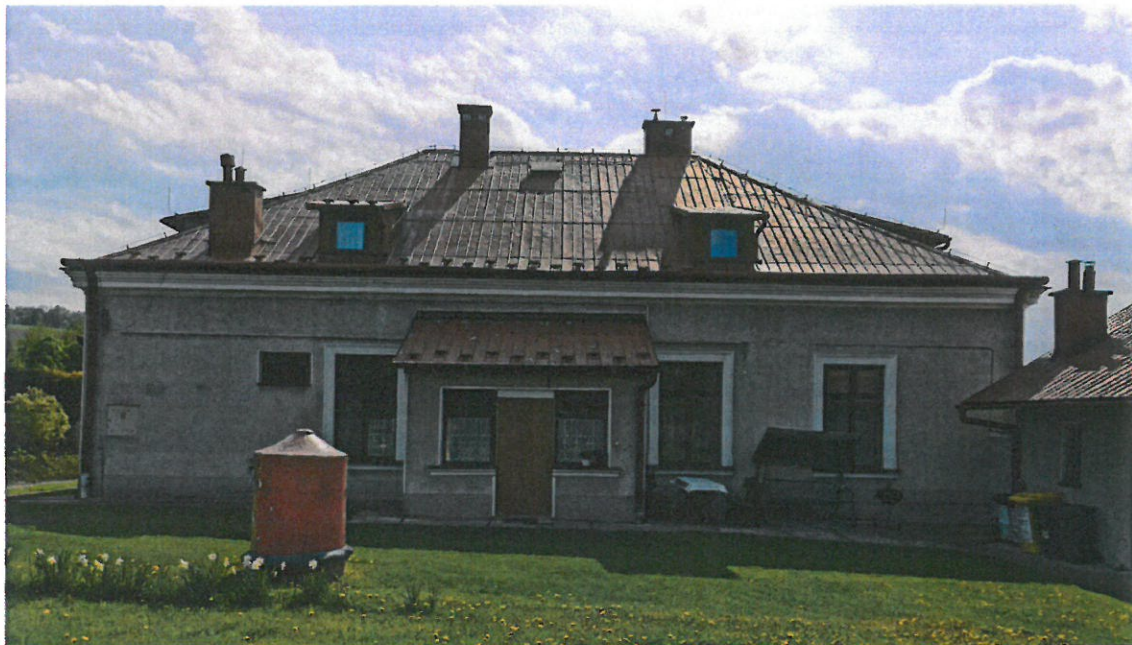
Fot. Nr 2. Budynek mieszkalny/przedszkole. Data powstania 1906-1910 r. Ul. Ks. Mazurkiewicza 34 Jasień. Gmina Brzesko. Widok ogólny elewacji budynku od strony pny/wsch. Stan: przed konserwacją. Widoczne: dobudowany w późniejszym okresie ganek, brak symetrii otworów okiennych, po prawej widoczne zabudowania gospodarcze, skrzynka inst. gazowej po lewej stronie. Fot. Wojciech Siek . 05. 2022
