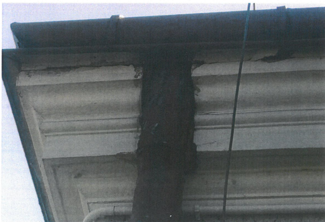
Fot. Nr 8. Budynek mieszkalny/przedszkole. Data powstania 1906-1910 r. Ul. Ks. Mazurkiewicza 34 Jasień. Gmina Brzesko. Zbliżenie rynny spustowej od strony płn./wsch. Stan: przed konserwacją. Widoczne: uszkodzony fragment profilowania gzymsu, korozja, osypujące się warstwy tynku, wzdłużne pęknięcie w-wy tynku. Fot. Wojciech Siek . 05. 2022
