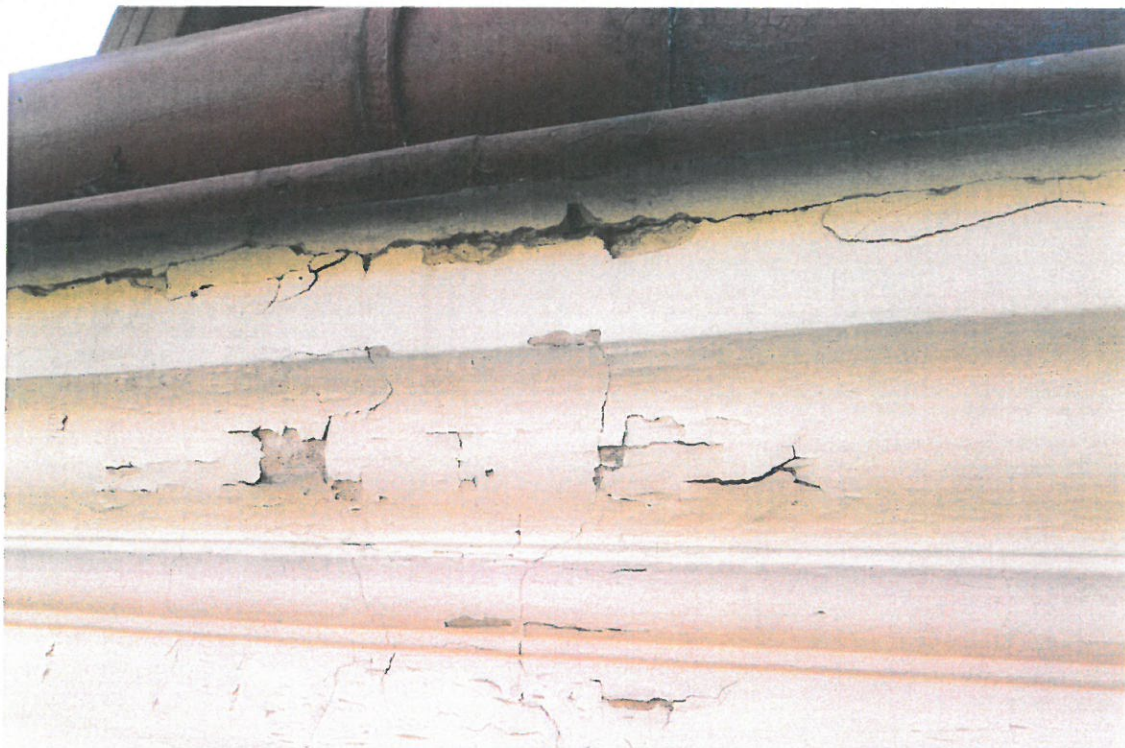
Fot. Nr 9. Budynek mieszkalny/przedszkole. Data powstania 1906-1910 r. Ul. Ks. Mazurkiewicza 34 Jasień. Gmina Brzesko. Zbliżenie fragmentu gzymsu od strony płn./wsch. Stan: przed konserwacją. Widoczne: uszkodzony fragment profilowania gzymsu – rozległe pęknięcia powstałe podczas montażu nowego poszycia dachowego, złuszczenia farby elewacyjnej. Wojciech Siek . 05. 2022
