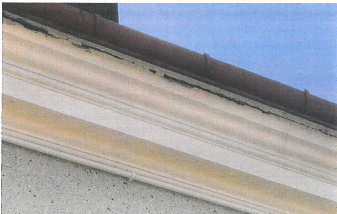
Fot. Nr 10. Budynek mieszkalny/przedszkole. Data powstania 1906-1910 r. Ul. Ks. Mazurkiewicza 34 Jasień. Gmina Brzesko. Zbliżenie fragmentu gzymsu od strony płn./wsch. Stan: przed konserwacją. Widoczne: uszkodzony fragment profilowania gzymsu – rozległe pęknięcia powstałe podczas montażu nowego poszycia dachowego, złuszczenia farby elewacyjnej, instalacja elektryczna. Fot. Wojciech Siek . 05. 2022
