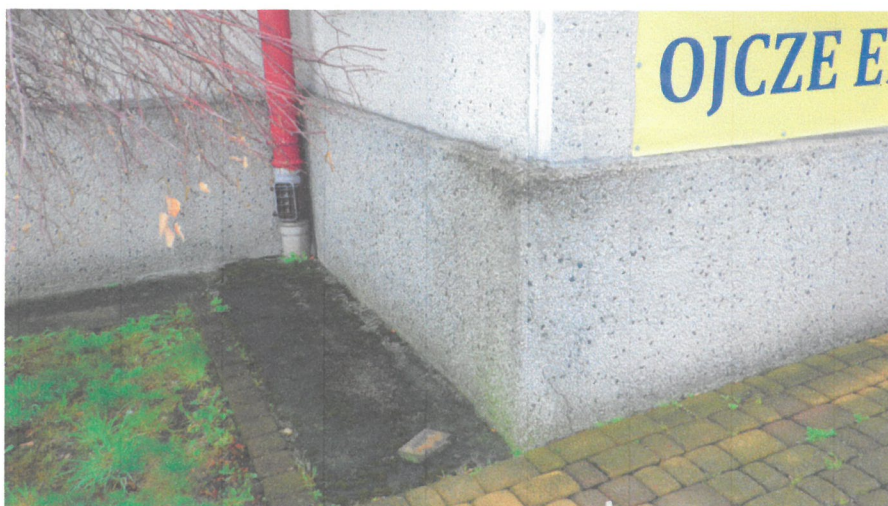
Fot.5) Narożnik ściany południowej z dobudowanym gankiem: rura spustowa, zdegradowana opaska betonowa, pęknięcia i zawilgocenia tynku na cokole.
