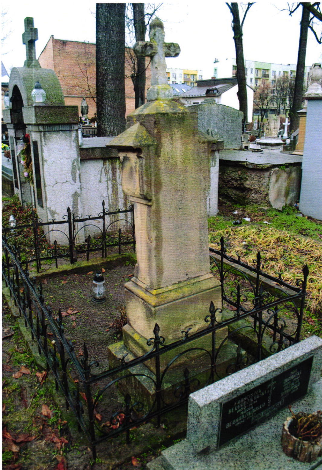
Fot. Nr 28. Cmentarz parafialny w Brzesku dat. na 1815 r. Gmina Brzesko. Ujęcie od str. wsch. kamiennego nagrobka rodziny Kubasiewiczów dat. Na 1873 r. Stan: przed konserwacją. Widoczne: ubytki kamienia, zabrudzenia, mchy i porosty, fałszywa patyna. Fot. Wojciech Siek 10. 2023 r.
