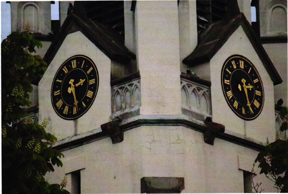
Fot. Nr 7. Gotycki kościół pw. św. Jakuba w Brzesku dat. na 1447 r. Zbliżenie środkowej partii wieży kościelnej elewacji od str. płd./wsch. Stan: przed konserwacją. Widoczne: silne zabrudzenia kamiennych elementów wystroju wieży, ubytki kamienia, pękanie. Fot. Wojciech Siek 04.2024 r.
