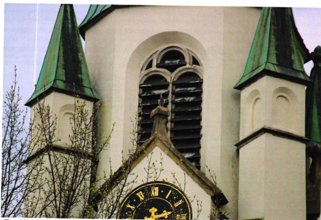
Fot. Nr 12. Gotycki kościół pw. św. Jakuba w Brzesku dat. na 1447 r. Zbliżenie środkowej partii wieży kościelnej elewacji od str. zach. Stan: przed konserwacją. Widoczne: silne zabrudzenia kamiennych elementów wystroju wieży, ubytki kamienia, pękanie. Fot. Wojciech Siek 04.2024 r.
