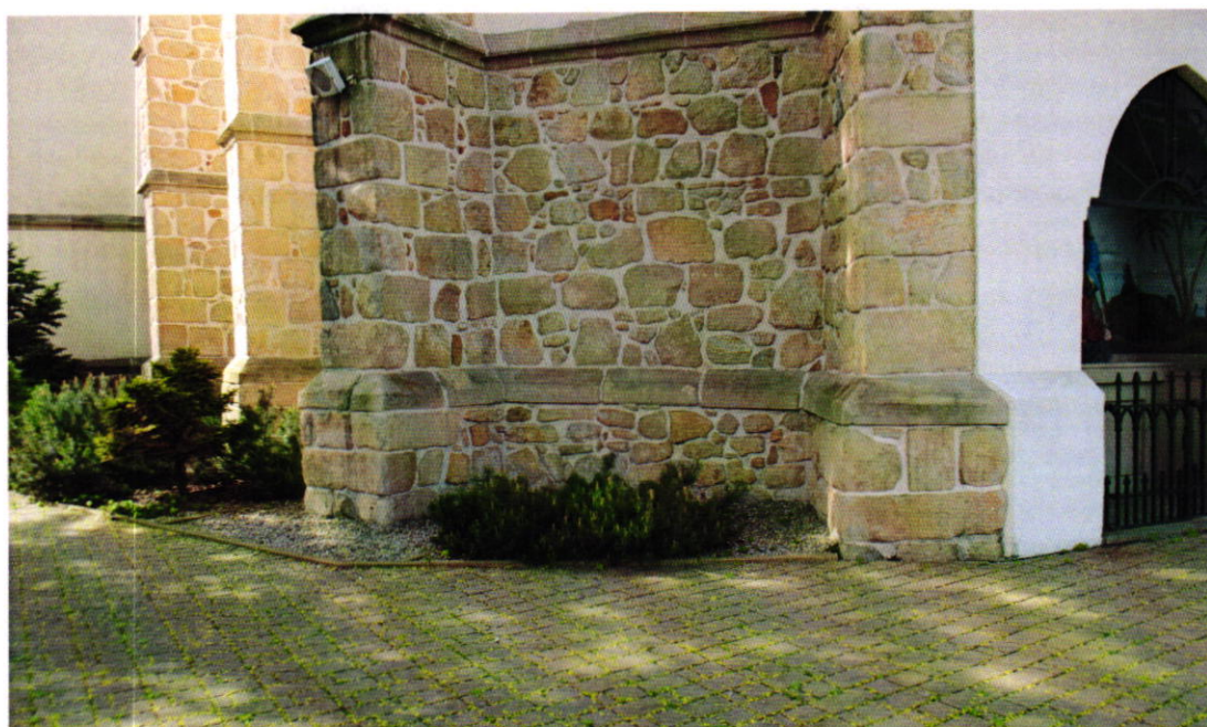
Fot. Nr 4. Gotycki kościół pw. św. Jakuba w Brzesku dat. na 1447 r. Zbliżenie dolnej partii elewacji od str. połd./wsch. Stan: przed konserwacją. Widoczne: wykonana podczas ostatniej konserwacji opaska z żwirem rzeczonym z obrzeżem betonowym i odwodnieniem murów obiektu. Fot. Wojciech Siek 04.2024 r.
