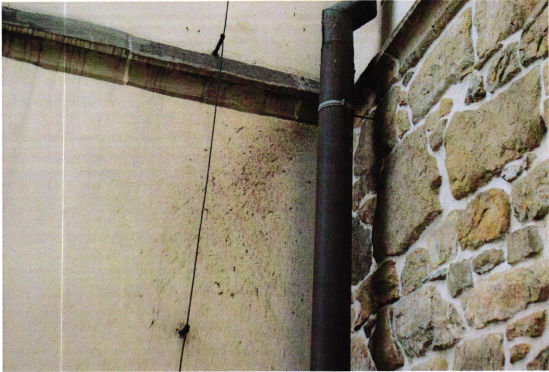
Fot. Nr 5. Gotycki kościół pw. św. Jakuba w Brzesku dat. na 1447 r. Zbliżenie środkowej partii elewacji od str. płd./wsch. Stan: przed konserwacją. Widoczne: zabrudzenia tynkowanej i malowanej elewacji oraz fragmentów kamieniarki ptasimi odchodami. Fot. Wojciech Siek 04.2024 r.
