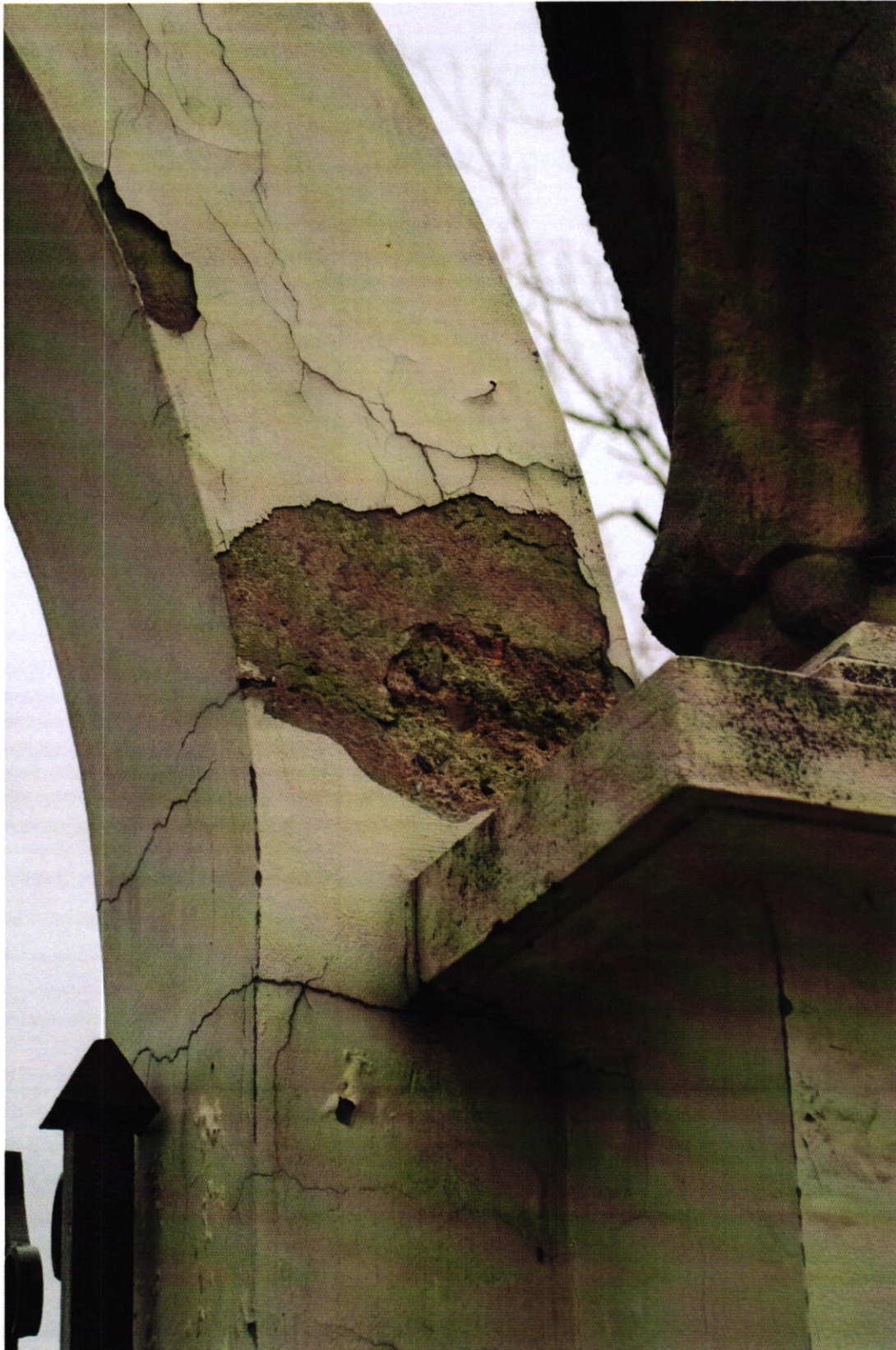
Fot Nr 9. Cmentarz parafialny w Brzesku dat. na 1815 r. Gmina Brzesko. Zbliżenie fragmentu pylonu bramy wejściowej. Stan: przed konserwacją. Widoczne: odsłonięty fragment ujawniający oryginalne warstwy tynku wapienno-cementowego oraz głębszych warstw materii, spękania i rozwarstwienia . Fot. Wojciech Siek 10. 2023 r.
