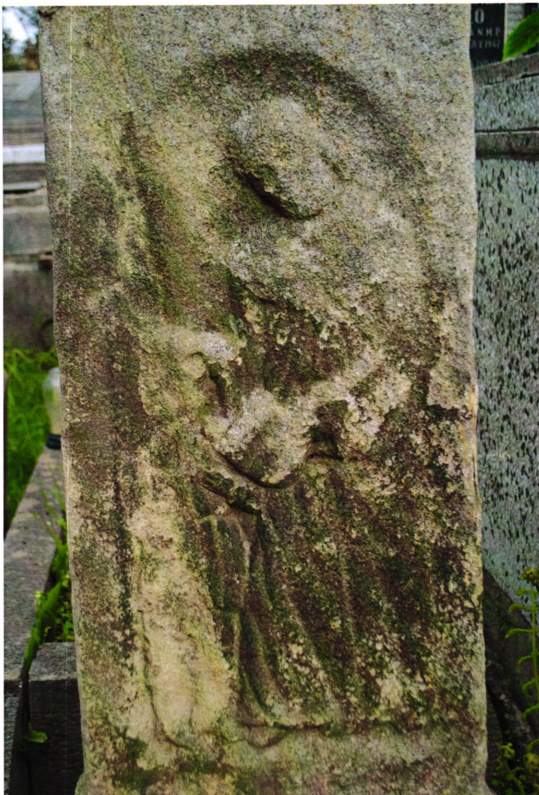
Fot Nr 17. Cmentarz parafialny w Brzesku dat. na 1815 r. Gmina Brzesko. Zbliżenie płaskorzeźby nagrobka nieznanego proboszcza parafii z I poł. XIX w. Stan: przed konserwacją. Widoczne: silne rozmycie formy rzeźbiarskiej płaskorzeźby, fałszywa patyna. Fot. Wojciech Siek 10. 2023 r.
