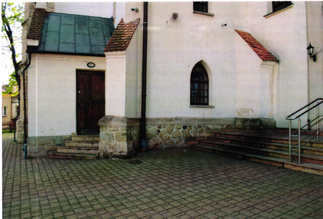
Fot. Nr 2. Gotycki kościół pw. św. Jakuba w Brzesku dat. na 1447 r. Ujęcie dolnej partii elewacji od str. płn./wsch. Stan: przed konserwacją. Widoczne: nawarstwienia ciemnej patyny na powierzchni kamiennej podmurówki, zawilgocenie-kolonie mikroorganizmów, kostka brukowa i współcześnie wykonane stopnie z kamienną okładziną, zastępujące oryginalne partie kamiennej podmurówki, Fot. Wojciech Siek 04.2024 r.
