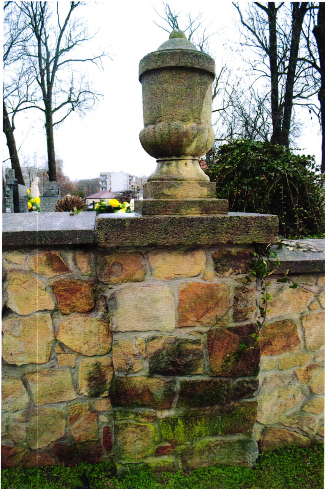
Fot Nr 5. Cmentarz parafialny w Brzesku dat. na 1815 r. Gmina Brzesko. Zbliżenie fragmentu płd. części muru cmentarza z amforą. Stan: przed konserwacją. Widoczne: zabrudzenia, fałszywa patyna, kolonie mikroorganizmów Fot. Wojciech Siek 10. 2023 r.
