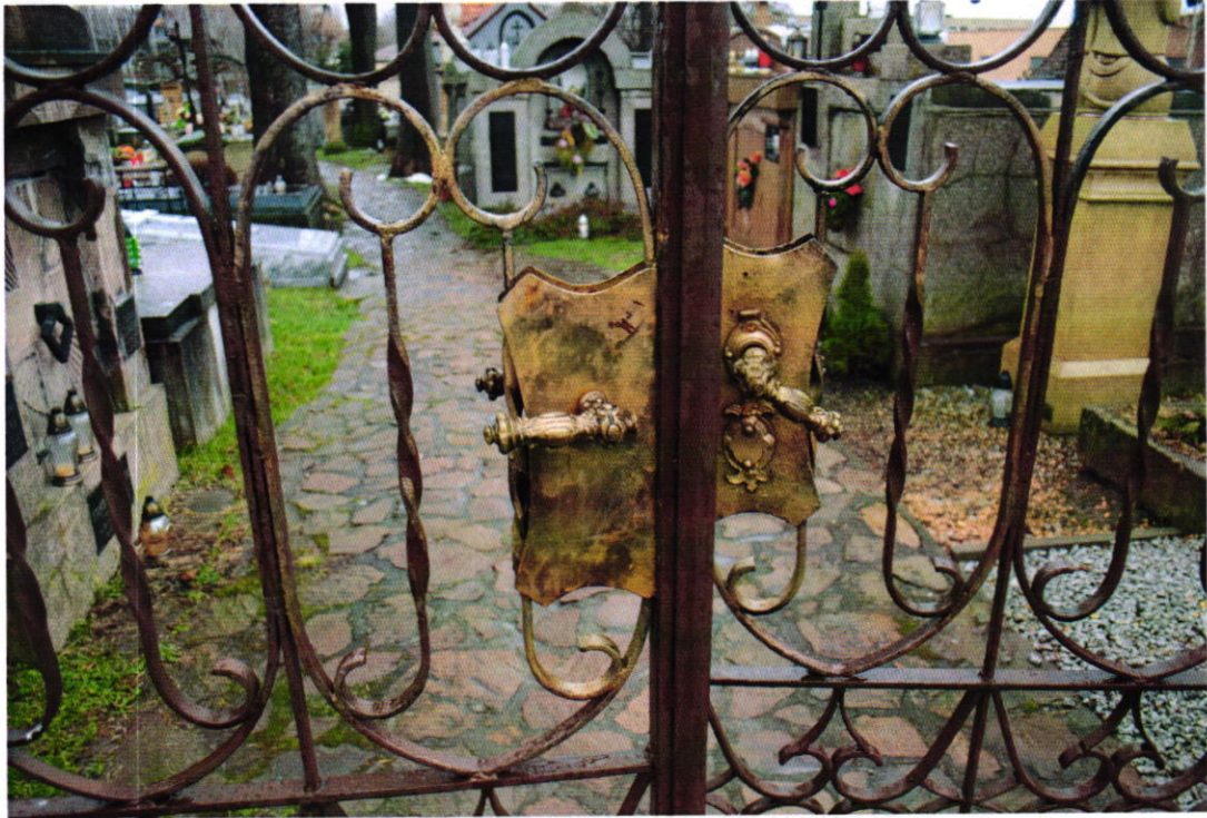
Fot Nr 13. Cmentarz parafialny w Brzesku dat. na 1815 r. Gmina Brzesko. Zbliżenie frontalne dwuskrzydłowej stalowej furty. Stan: przed konserwacją. Widoczne: przemalowania brązową farbą olejną, ogniska korozji. Fot. Wojciech Siek 10. 2023 r.
