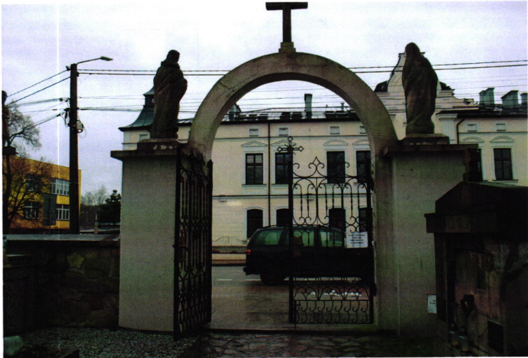
Fot Nr 14. Cmentarz parafialny w Brzesku dat. na 1815 r. Gmina Brzesko. Ujęcie bramy cmentarza od str. płd. Stan: przed konserwacją. Widoczne: złuszczające się nawarstwienia farb, spękania, ubytki, zabrudzenia, fałszywa patyna, rozmyte detale rzeźbiarskie figur. Fot. Wojciech Siek 10. 2023 r.
