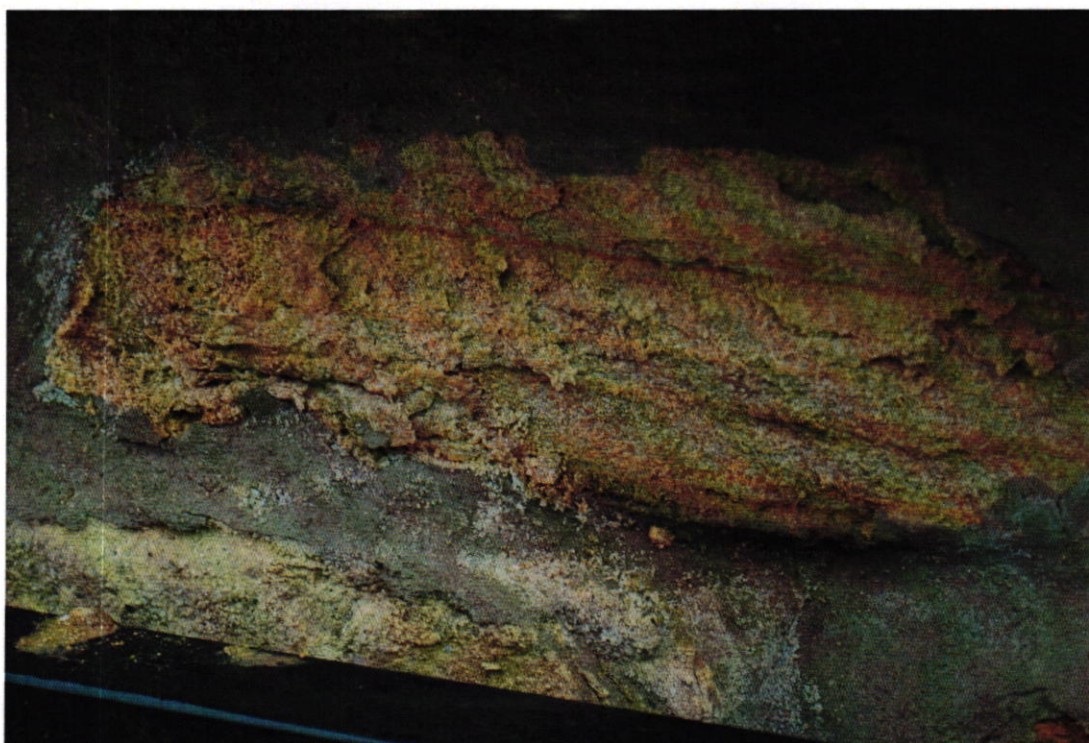
Fot Nr 4. Cmentarz parafialny w Brzesku dat. na 1815 r. Gmina Brzesko. Zbliżenie fragmentu płd. części muru cmentarza. Stan: przed konserwacją. Widoczne: dezintegracja kamienia w wyniku działania szkodliwych soli, zabrudzenia, fałszywa patyna. Fot. Wojciech Siek 10. 2023 r.
