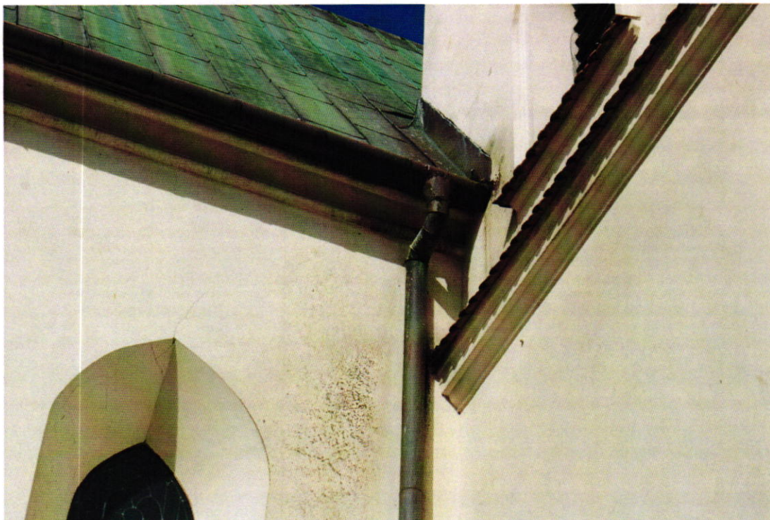
Fot. Nr 6. Gotycki kościół pw. św. Jakuba w Brzesku dat. na 1447 r. Zbliżenie środkowej partii elewacji od str. płd./zach. Stan: przed konserwacją. Widoczne: niedrożne rynny, zabrudzenia tynkowanej i malowanej elewacji ptasimi odchodami. Fot. Wojciech Siek 04.2024 r.
