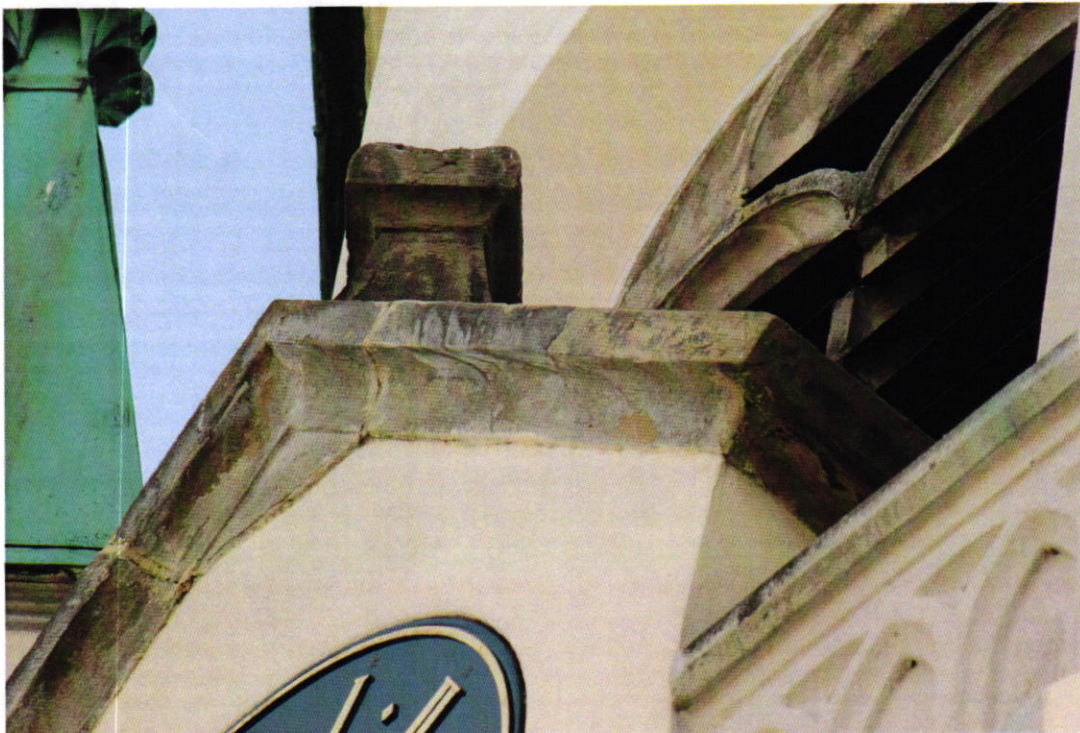
Fot. Nr 9. Gotycki kościół pw. św. Jakuba w Brzesku dat. na 1447 r. Zbliżenie środkowej partii wieży kościelnej elewacji od str. płd./wsch. Stan: przed konserwacją. Widoczne: silne zabrudzenia kamiennych elementów wystroju wieży- fałszywa patyna, przebarwienia i ubytki kamienia. Fot. Wojciech Siek 04.2024 r.
