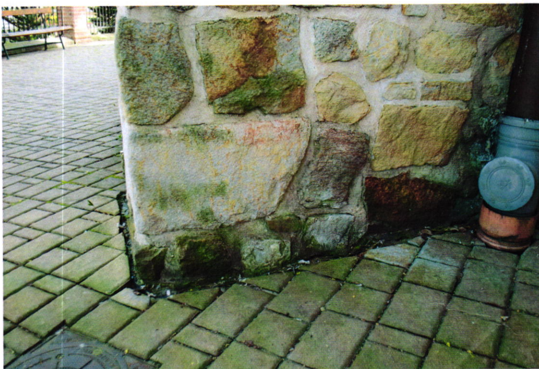
Fot. Nr 3. Gotycki kościół pw. św. Jakuba w Brzesku dat. na 1447 r. Zbliżenie dolnej partii elewacji od str. półn./wsch. Stan: przed konserwacją. Widoczne: zawilgocenie-kolonie mikroorganizmów, kostka brukowa- kumulująca wilgoć w podłożu i przyczyniająca się do wnikania wody odpryskowej w obiekt. Fot. Wojciech Siek 04.2024 r.
