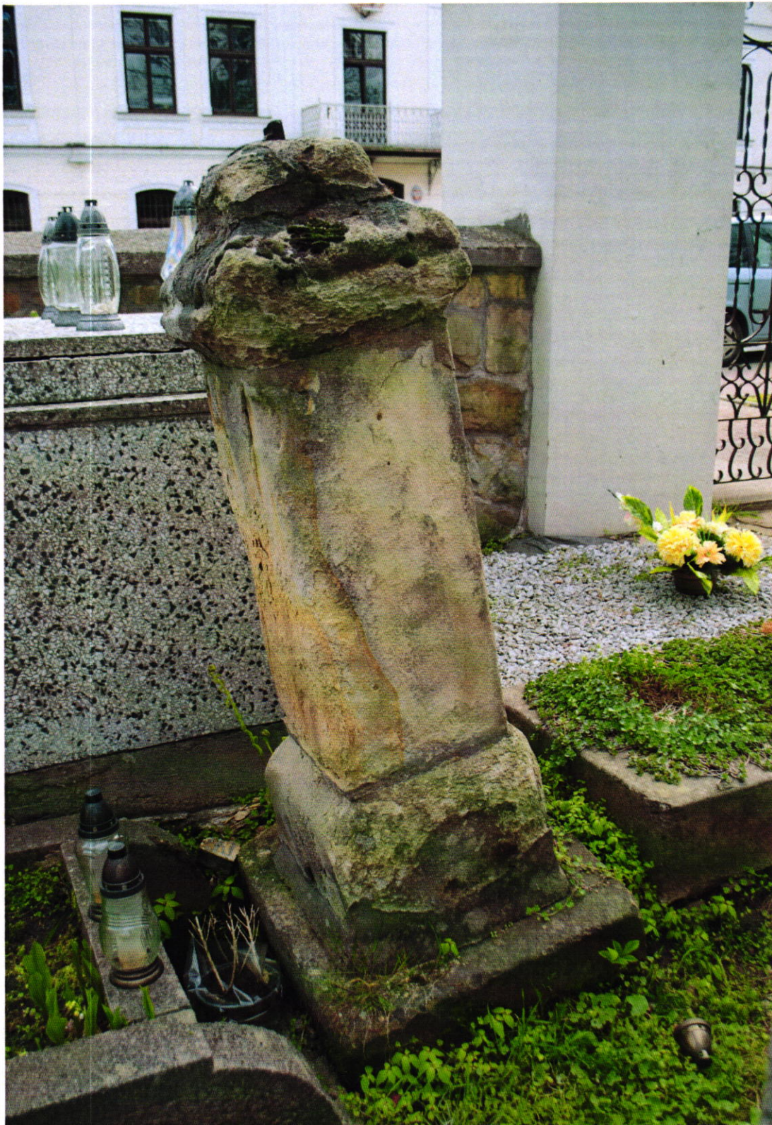
Fot Nr 16. Cmentarz parafialny w Brzesku dat. na 1815 r. Gmina Brzesko. Ujęcie ogólne od str. płu. kamiennego nagrobka nieznanego proboszcza parafii z I poł. XIX w. Stan: przed konserwacją. Widoczne: przechylenie obiektu, silne rozmycie formy architektonicznej elementów cokołu, uzupełnienia wykonane z zaprawy cementowej, mchy i porosty, fałszywa patyna, utracony żeliwny krzyż. Fot. Wojciech Siek 10. 2023 r.
