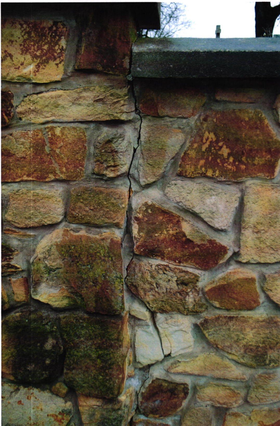
Fot Nr 6. Cmentarz parafialny w Brzesku dat. na 1815 r. Gmina Brzesko. Zbliżenie fragmentu płd. części muru cmentarza. Stan: przed konserwacją. Widoczne: rozległe pęknięcie na łączeniu segmentów muru, zabrudzenia, fałszywa patyna, kolonie mikroorganizmów. Fot. Wojciech Siek 10. 2023 r.
