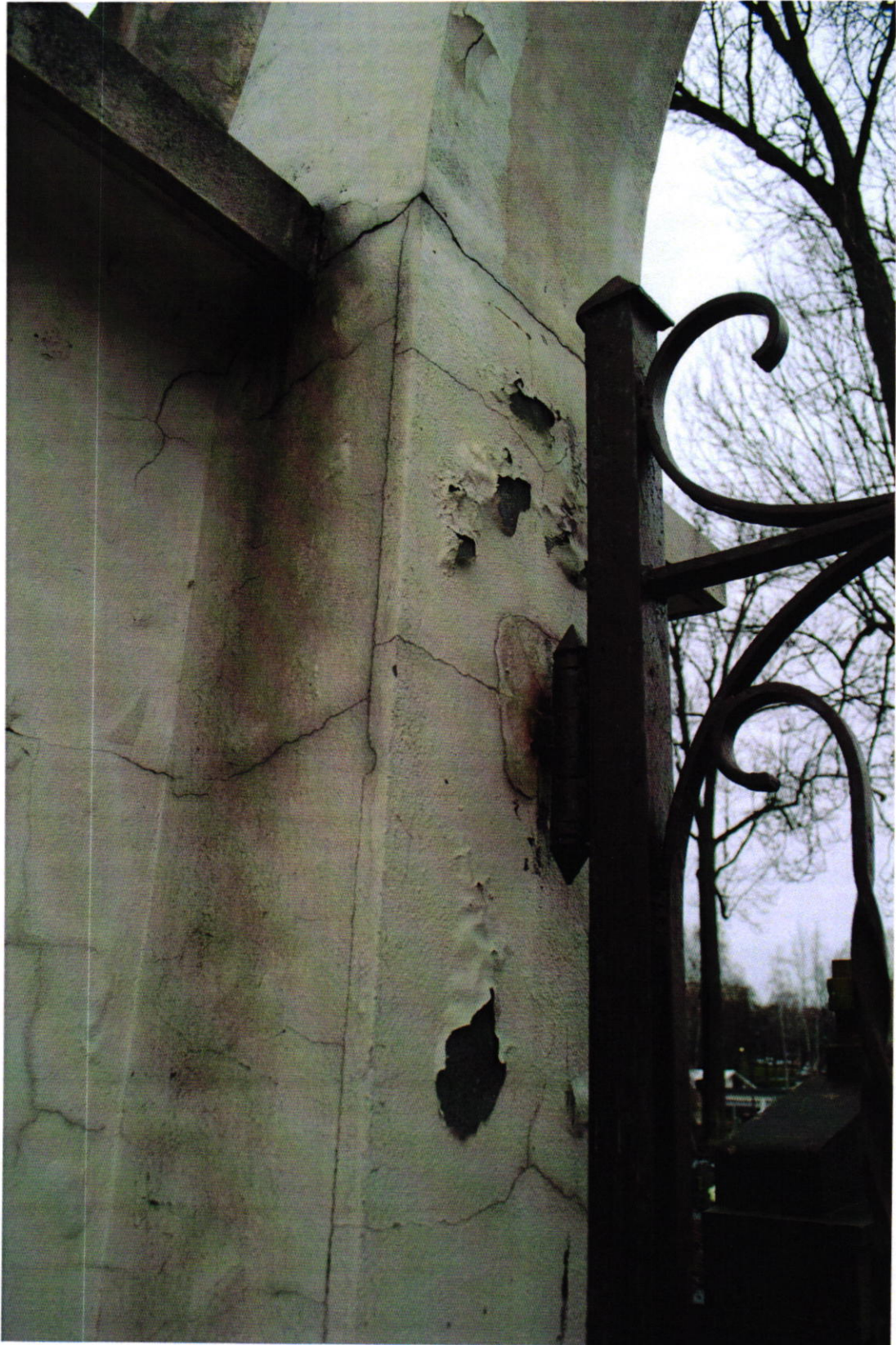
Fot Nr 10. Cmentarz parafialny w Brzesku dat. na 1815 r. Gmina Brzesko. Zbliżenie fragmentu pylonu bramy wejściowej. Stan: przed konserwacją. Widoczne: zabrudzenia, złuszczające się warstwy malarskie, spękania i rozwarstwienia cementowej zaprawy wyrównującej. Fot. Wojciech Siek 10. 2023 r.
