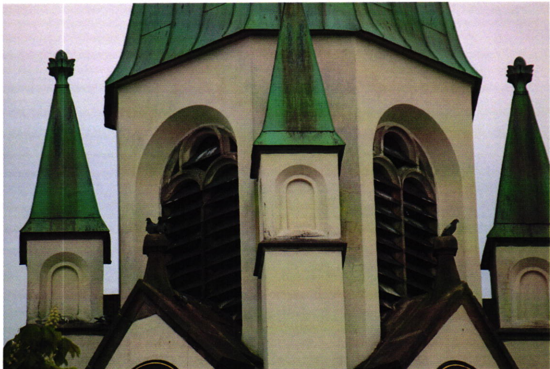
Fot. Nr 8. Gotycki kościół pw. św. Jakuba w Brzesku dat. na 1447 r. Zbliżenie środkowej partii wieży kościelnej elewacji od str. płd./wsch. Stan: przed konserwacją. Widoczne: silne zabrudzenia kamiennych elementów wystroju wieży, ubytki kamienia, pękanie. Fot. Wojciech Siek 04.2024 r.
