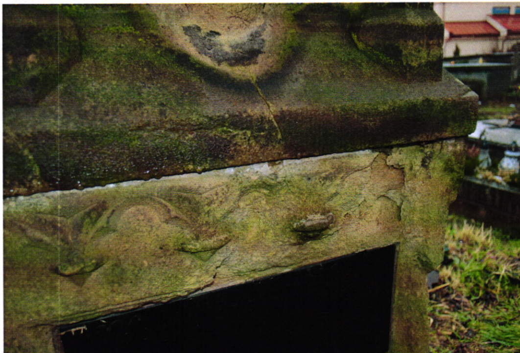
Fot. Nr 22. Cmentarz parafialny w Brzesku dat. na 1815 r. Gmina Brzesko. Zbliżenie detali kamiennego nagrobka Franciszka Lisaka z 1909 r. Stan: przed konserwacją. Widoczne: ubytki formy detali architektonicznych nagrobka i elementów rzeźbionych, mchy i porosty, fałszywa patyna. Fot. Wojciech Siek 10. 2023 r.
